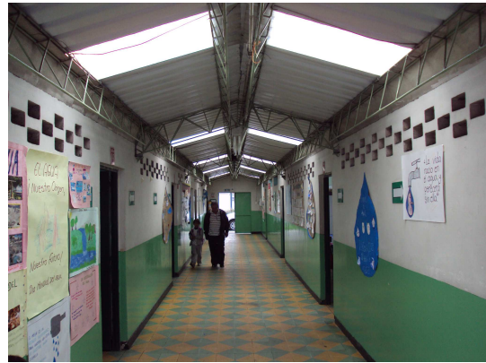
Vista interior de la cubierta acústica instalada
