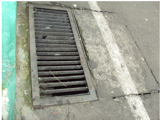
Estado actual del remate en las cajas de inspección
